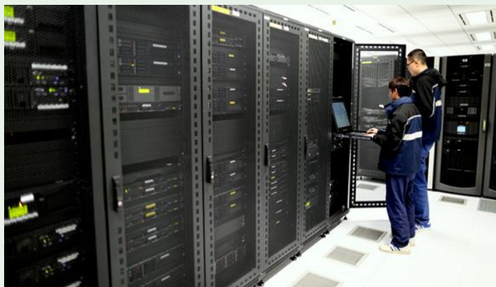
數據中心職員在海關總部大樓為電腦伺服器進行系統維修檢查
