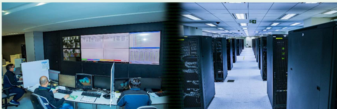
數據中心職員在海關總部大樓全天候監察電腦伺服器的運作
