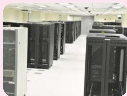
海關總部大樓數據中心內貌。
