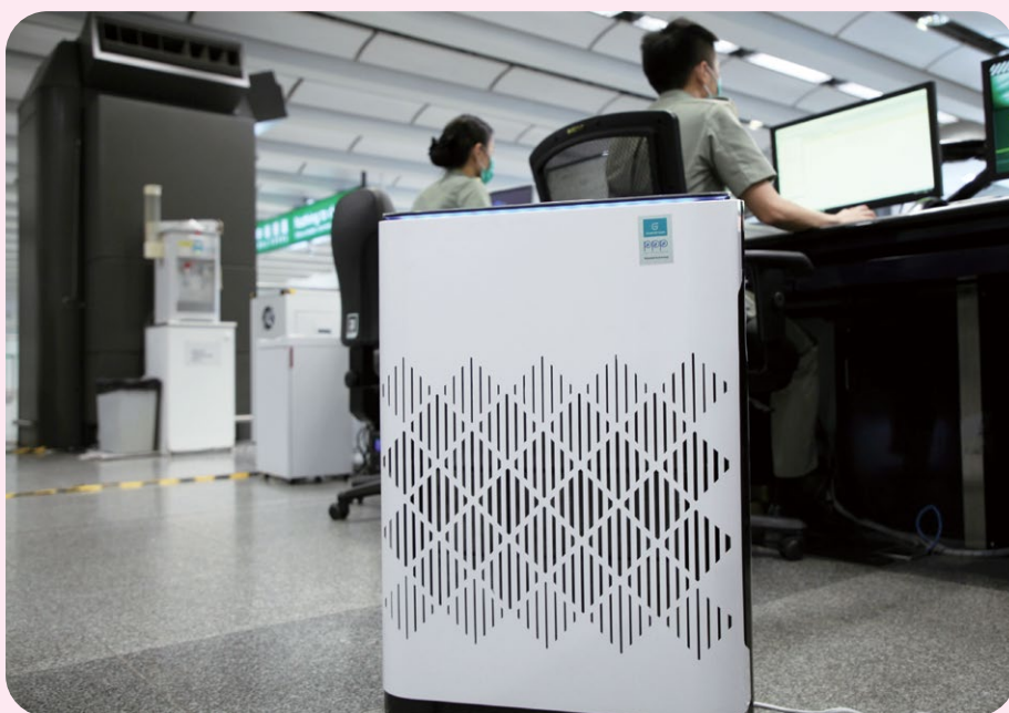
在海關清關室及簡報室內放置醫療級別空氣淨化機，有效殺掉多種病毒和細菌，防止傳播。
