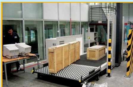
安裝在超級一號貨站的開放管道式X光機。
